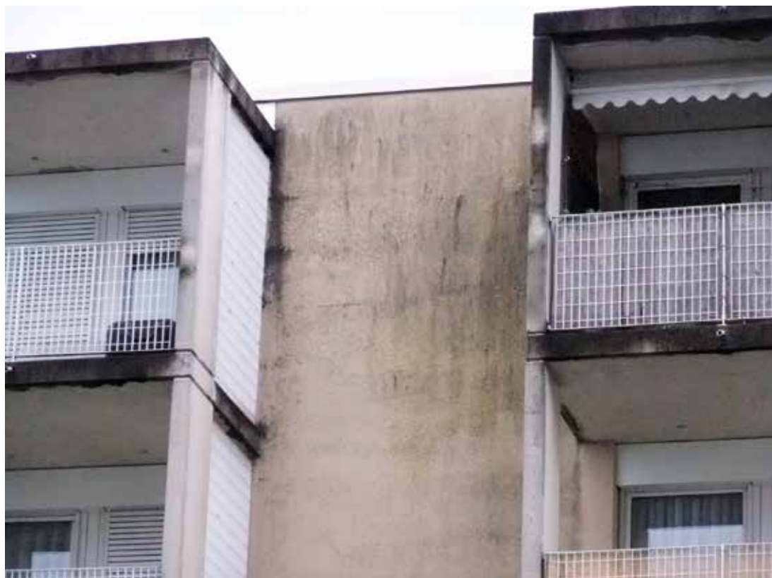
Façades souillées par la prolifération d'algues et de champignons
